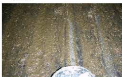
1 Zaúhlené drážky příliš daleko od sebe
